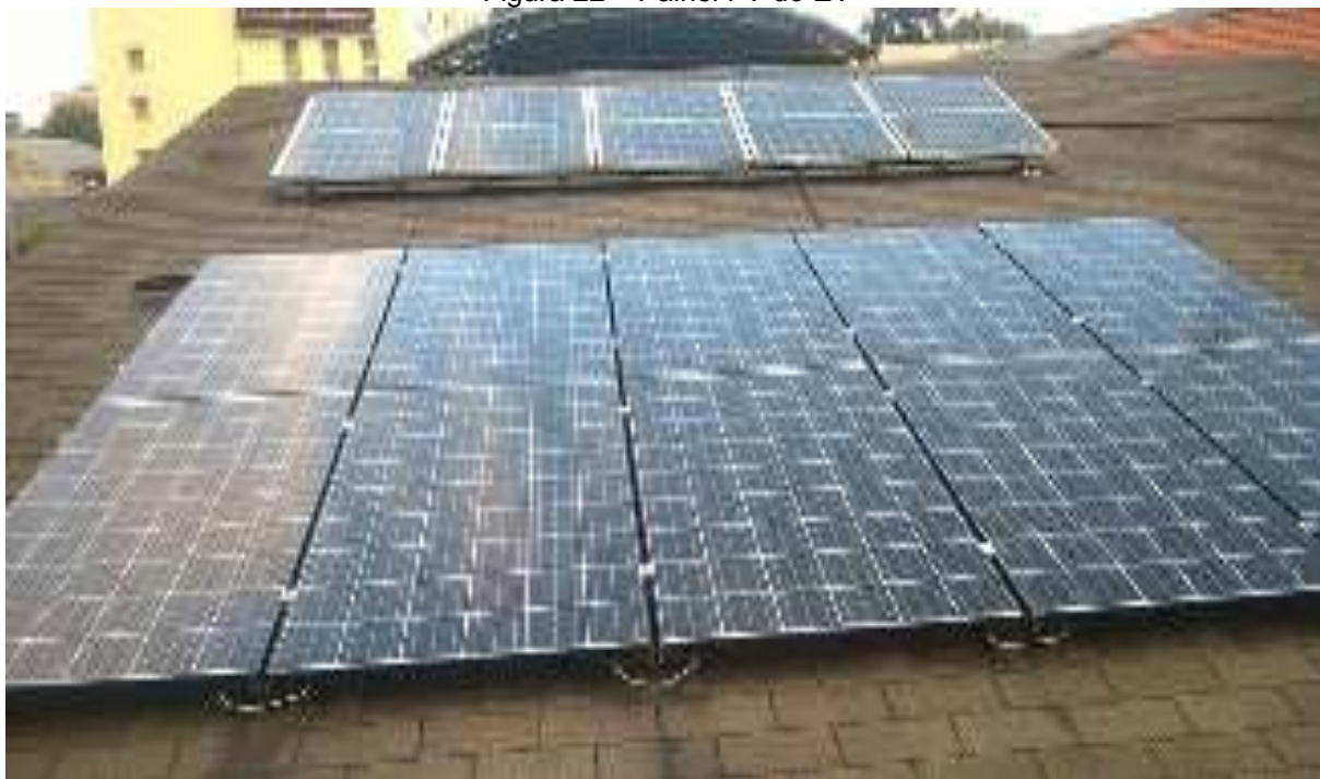
Figura 22 – Paineis FV do EV
