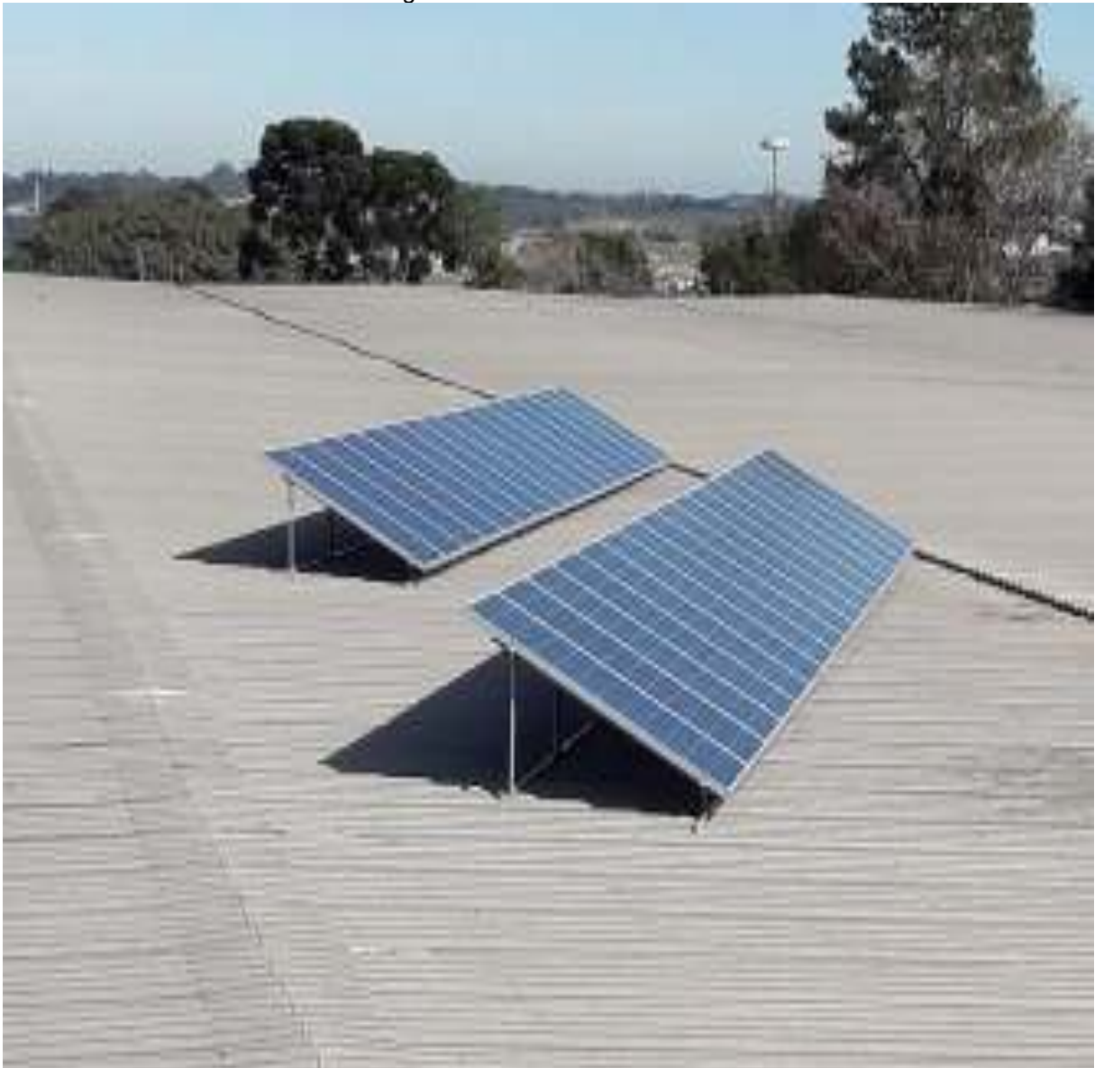
Figura 23 – Painel FV da sede Neoville
