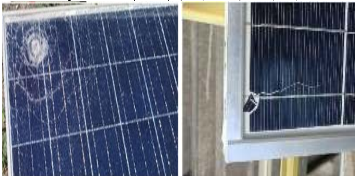
Figura 17 – Módulo quebrado (esquerda) e célula quebrada (direita)
