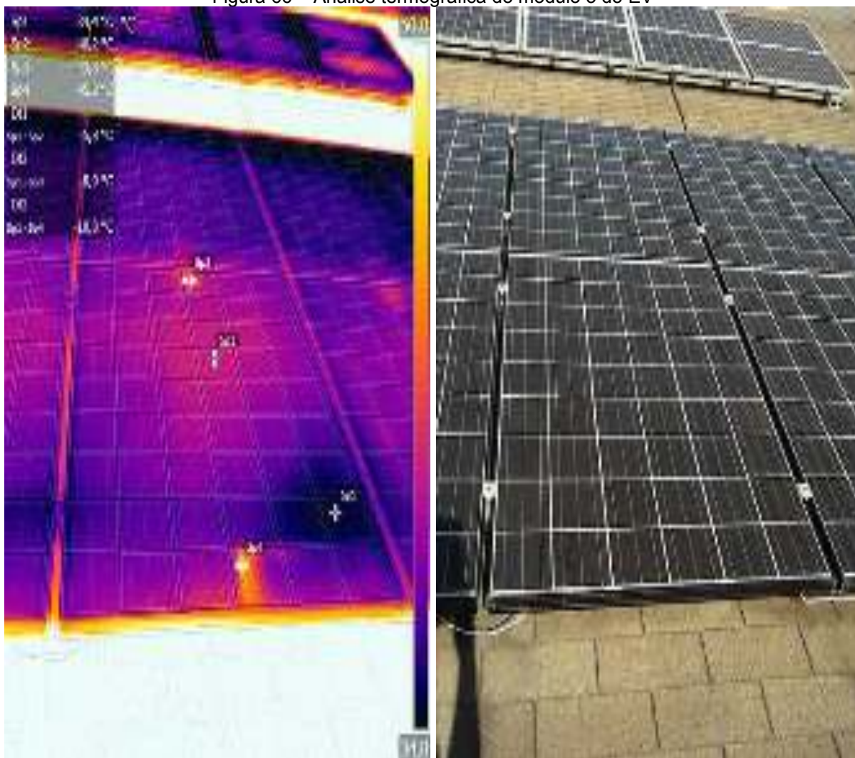
Figura 66 – Análise termográfica do módulo 3 do EV
