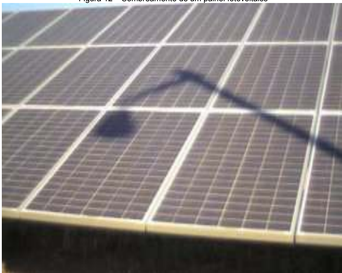
Figura 12 – Sombreamento de um painel fotovoltaico
