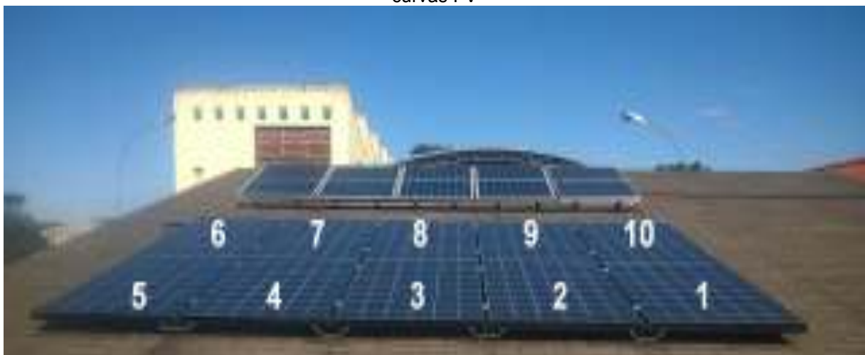
Figura 59 – Numeração dos módulos do EV em que foram realizados os testes com o traçador de curvas I-V
