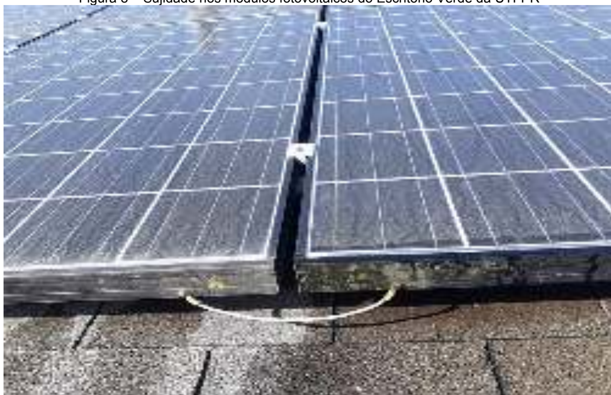
Figura 8 – Sujidade nos módulos fotovoltaicos do Escritório Verde da UTFPR
