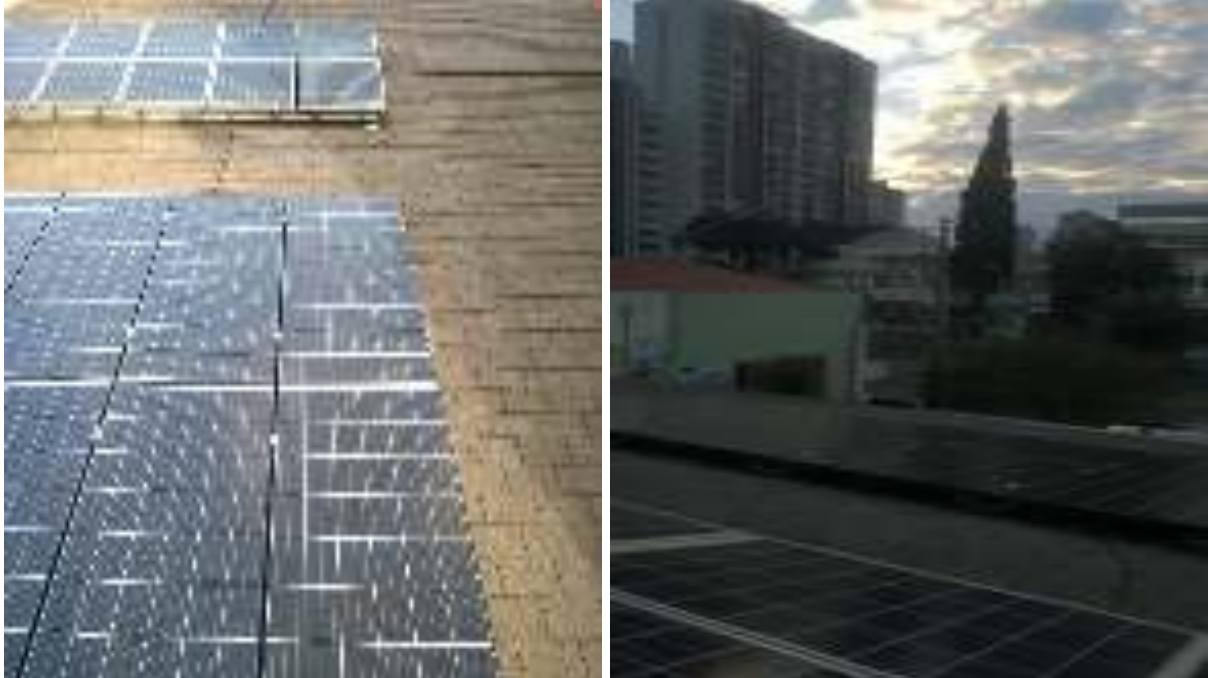
Figura 43 – Painel fotovoltaico do EV com sombreamento parcial às 16:15 (esquerda) e sombreamento total às 17:00 (direita)
