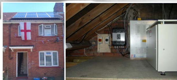
Figura 2 - Sistema fotovoltaico com armazenamento.
