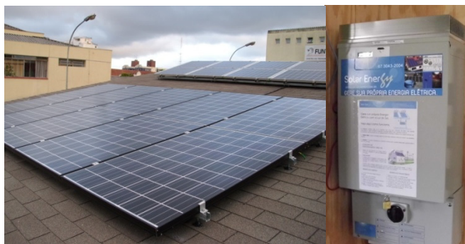
Figura 2 - Painel FV e inversor do EV da UTFPR.
